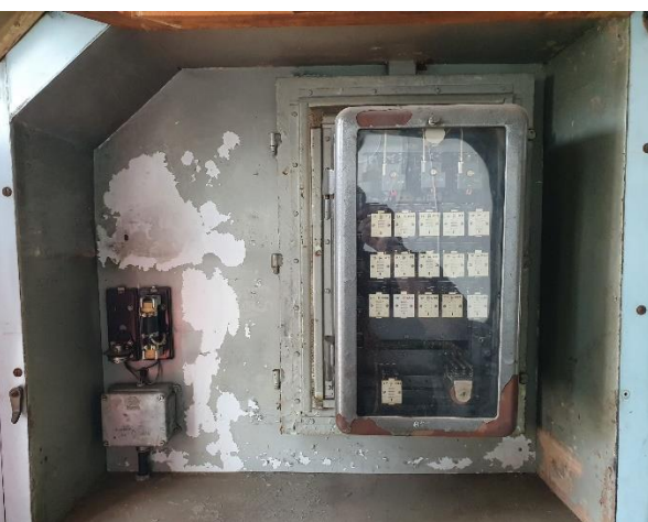
obr.19 Skříň ochrany a stabilizátor rychloměrů
