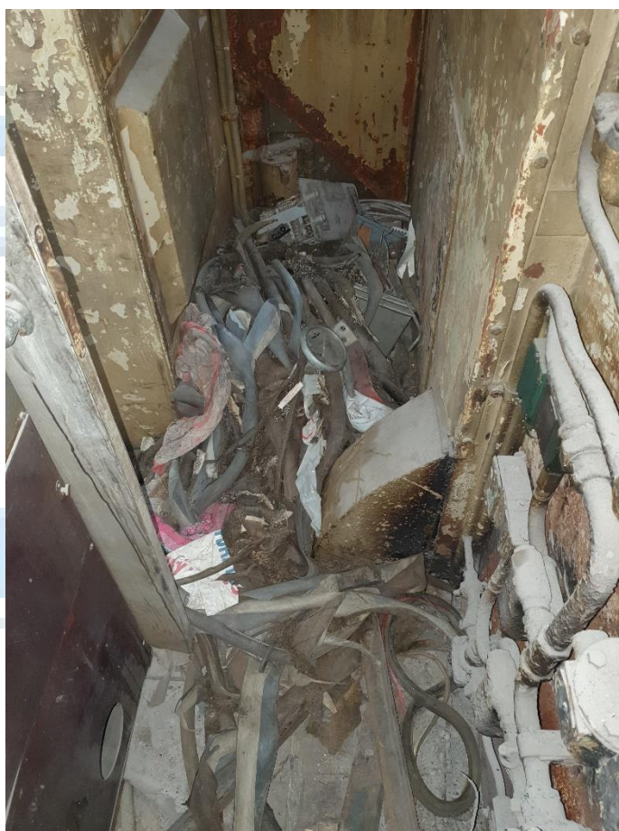
obr.1 Nepořádek ve strojovně.
