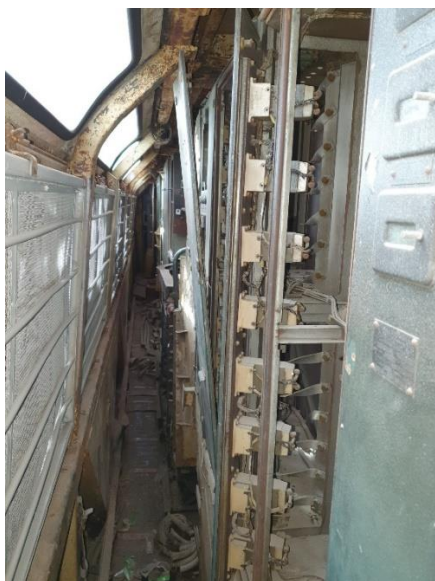
obr.9 Stav trakčního usměrňovače
