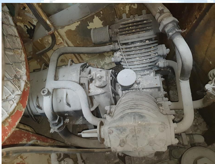
obr.5 Kompresorové soustrojí K1
