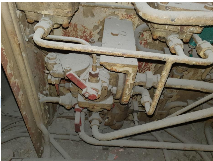
obr.4 Stav vzduchového zařízení
