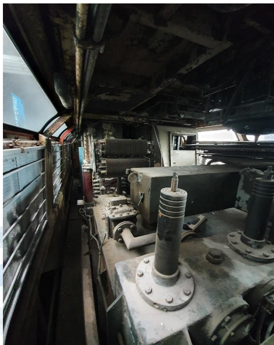
obr.7 Stav hl. transformátoru
