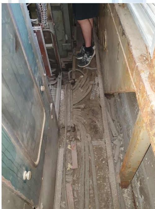
obr.16 Stav VN kabeláže
