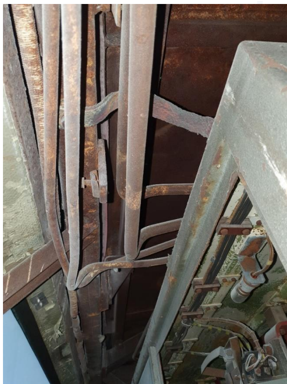
obr.2 Požárem poškozený strop a potrubí.
