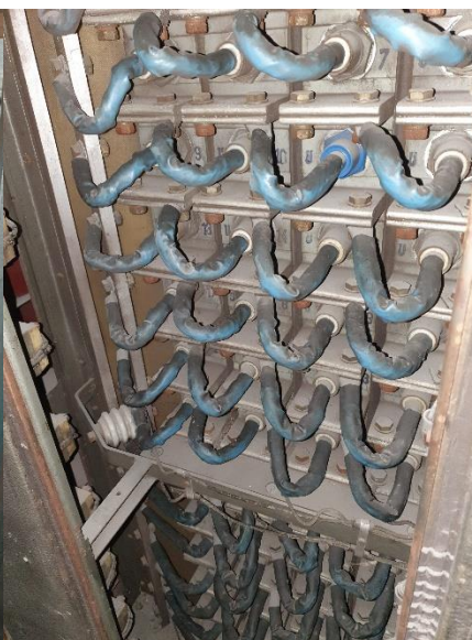
obr.11 Zachovalá část trak.usm.
